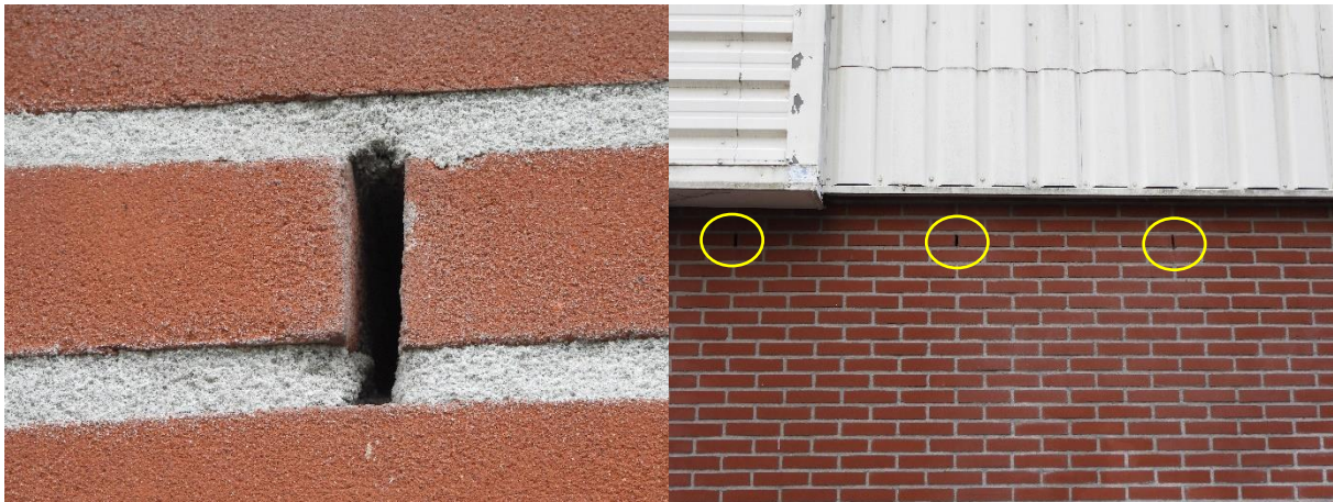
Zichtbare openstootvoegen vormen een potentiële invliegopening in het kantoorgebouw (gele cirkels).
